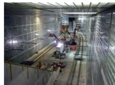
City-Tunnel Leipzig: Station Wilhelm-Leuschner-Platz
